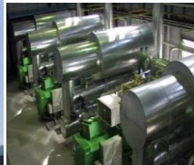
Машинные залы энергообъектов
